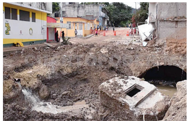
El barrio San Francisco fue uno de los más afectados con la destrucción del concreto hidráulico y el derrumbe de dos casas. Archivo CP
