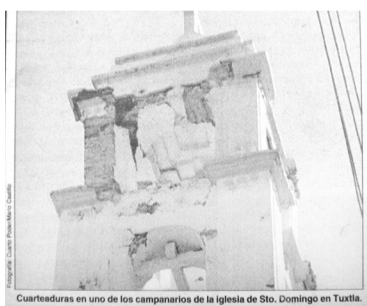
Un sismo en Villaflores causó estragos incluso en la capital. En la gráfica el campanario destrozado de la iglesia de Santo Domingo. CP/AGE
